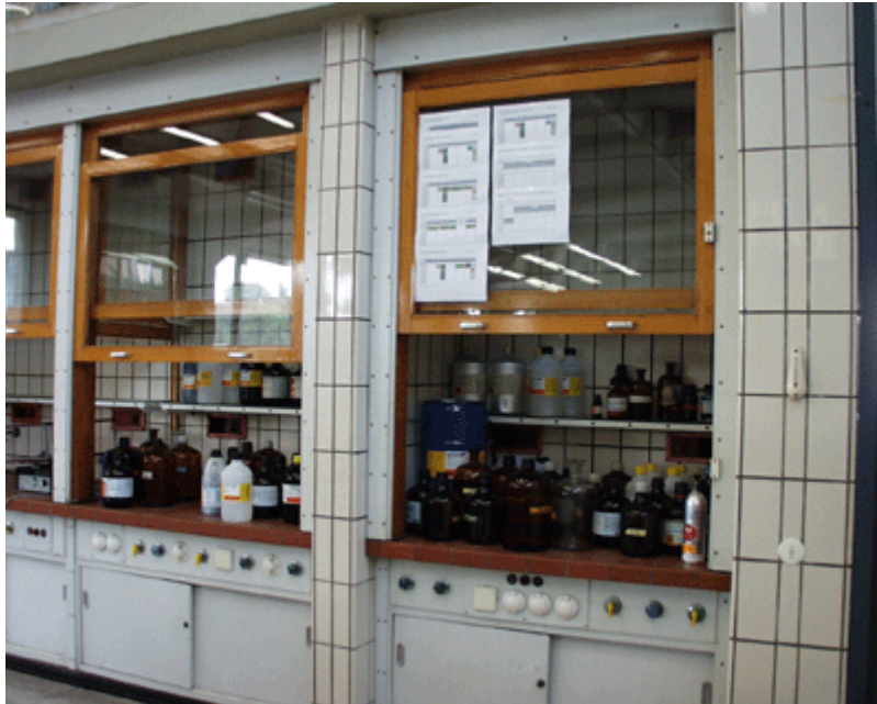
Abbildung 1: Alle gefährlichen Chemikalien werden unter dem Abzug gelagert. Die Handhabung erfolgt ebenfalls unter dem Abzug.
